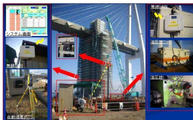
図-2 計測機器および通信機器
